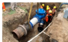
2. Aislamiento del Sector e Instrumentación del punto de ingreso con Medición de Flujo y Controlador de VEP's Neptune PM
