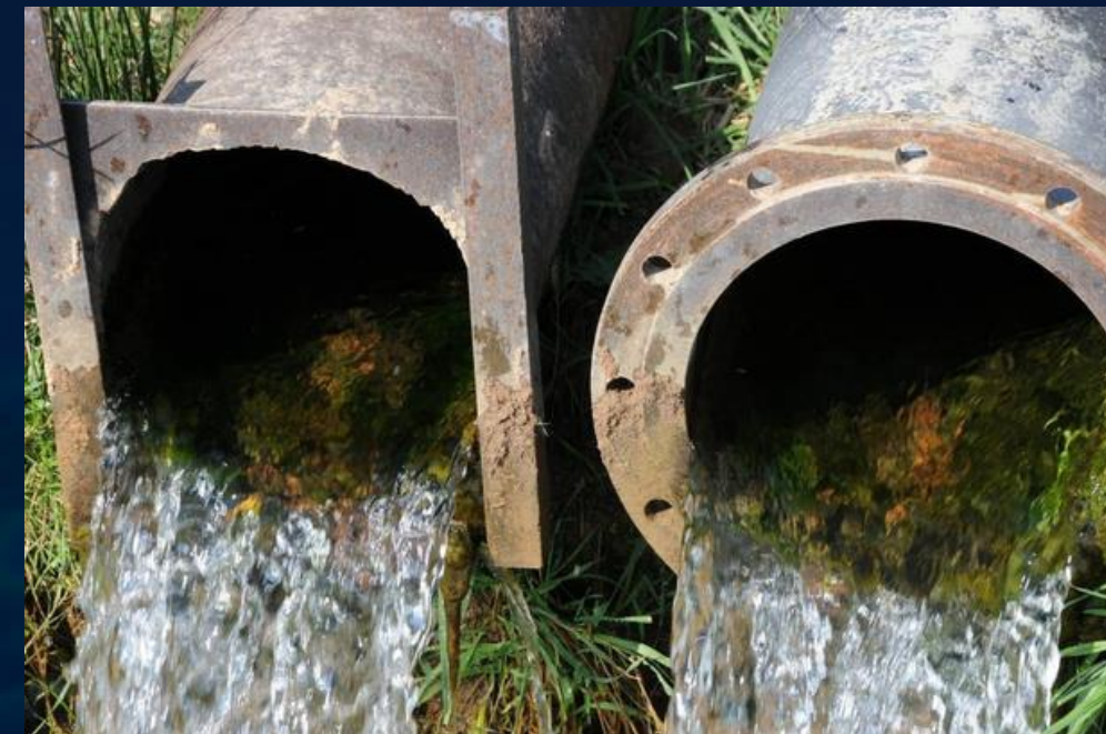
DESCARGAS EN MAL ESTADO
